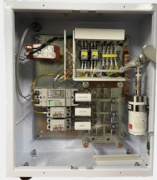
[분전반 내부 - 소화기 설치]
